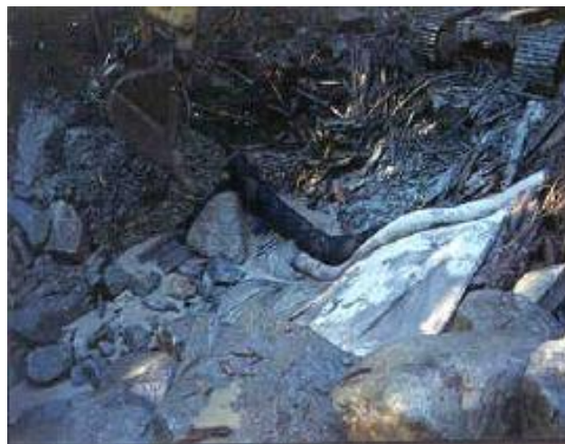
Figura 4. Instalação de geotêxtil em aterro inadequado.
